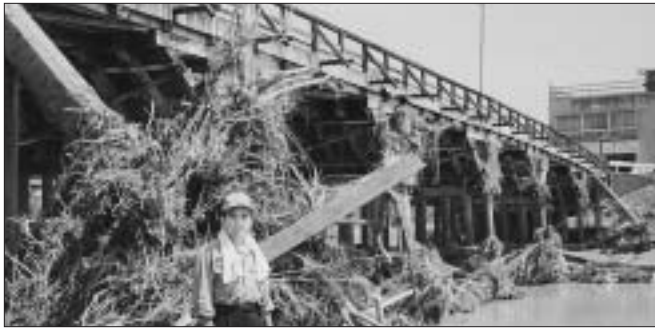
水位が上昇し崩壊の危機に直面した橋
