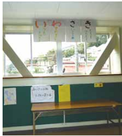
小学校校舎に設置された耐震フレーム (H23年11月撮影)
