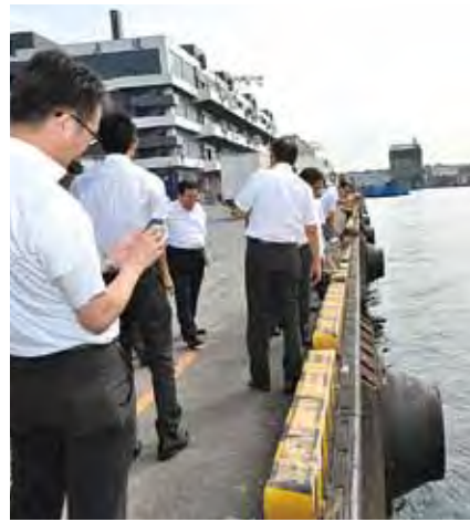
港湾施設の老朽化を視察 (H24年8月)
