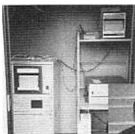
▲設置された 測定器(H13.4)
